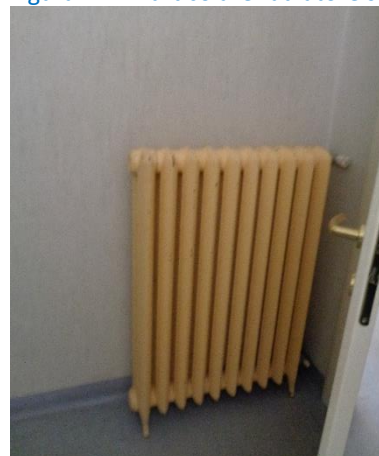
Figura 4.7 - Particolare radiatore servizi igienici
