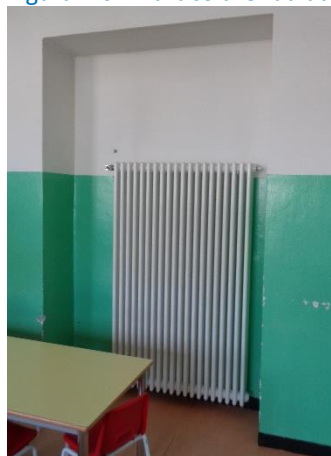
Figura 4.6 – Particolare radiatore su parete interna
