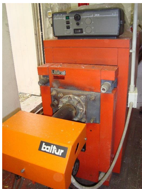
Figura 4.10 - Particolare generatore di calore
