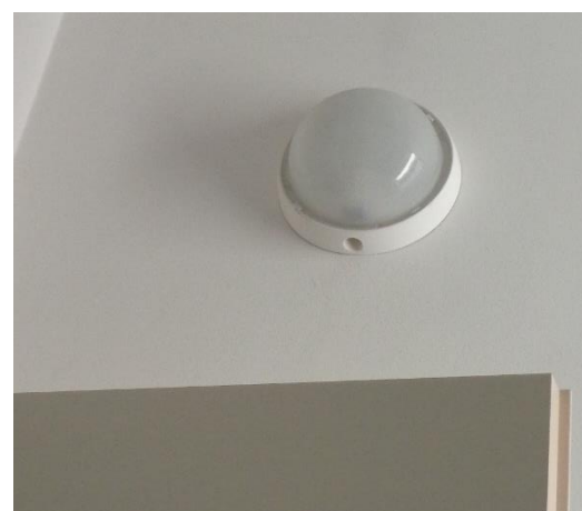
Figura 4.16 - Particolare dei corpi illuminanti servizi igienici secondo piano
