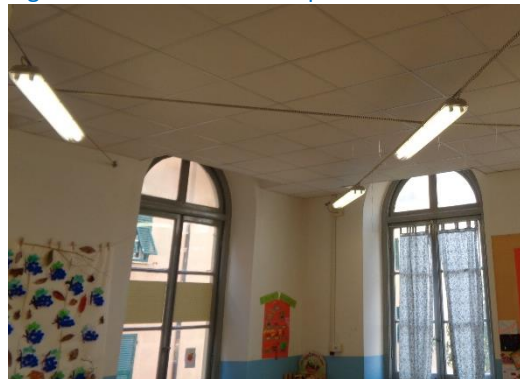
Figura 4.14 - Particolare corpi illuminanti aule
